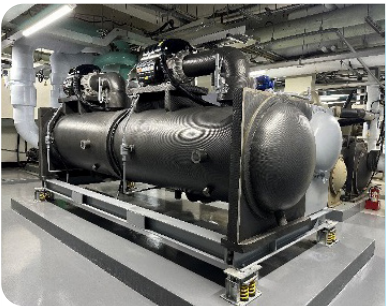
中興院區材化所 77 館中央空調系統優化
